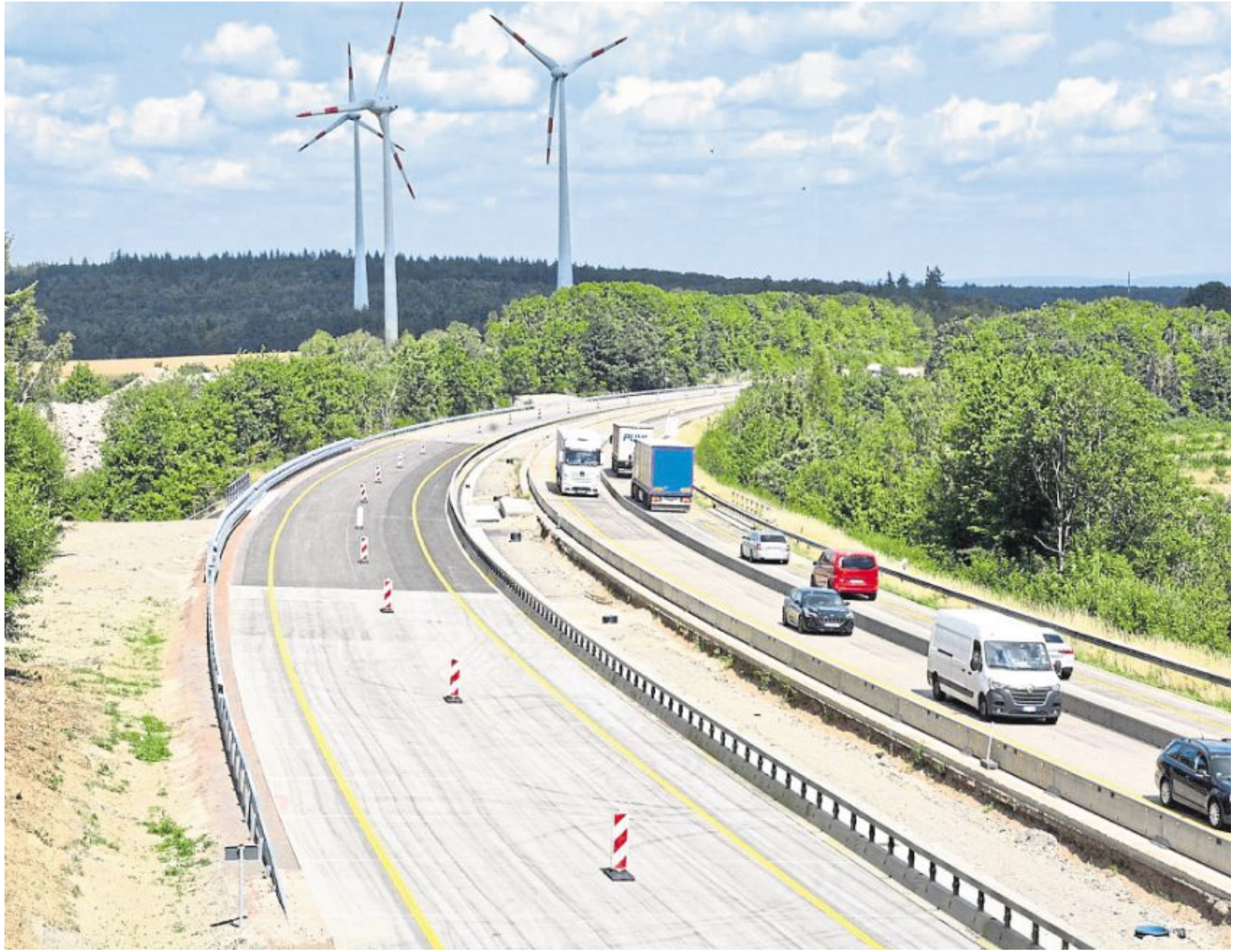
Die neue Fahrbahn der A1 zwischen Mehring und Reinsfeld ist in Fahrtrichtung Saarbrücken (links im Bild) so gut wie fertig. Dort stehen auch schon die Fahrspur-Markierungen bereit für den nächsten Sanierungsabschnitt, wenn die Baustelle in Kürze auf die Gegenfahrbahn wechselt. Foto: Christa Weber/Volksfreund
