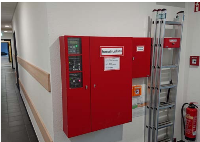
Abb. 6 Notfalleinrichtungen für die Feuerwehr
