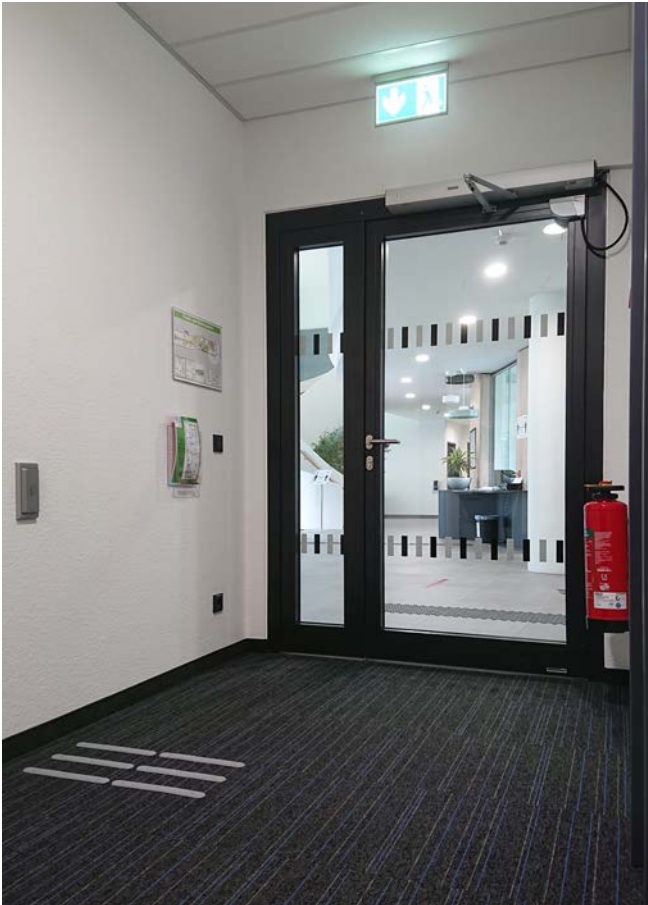
Abb. 12 Flucht- und Rettungswege: Gekennzeichnete Glasflächen, hinterleuchtete Fluchtwegbeschilderung, Rettungswegeplan, Feuerlöscher, Türöffnungstaster mit Aufmerksamkeitsfeld
